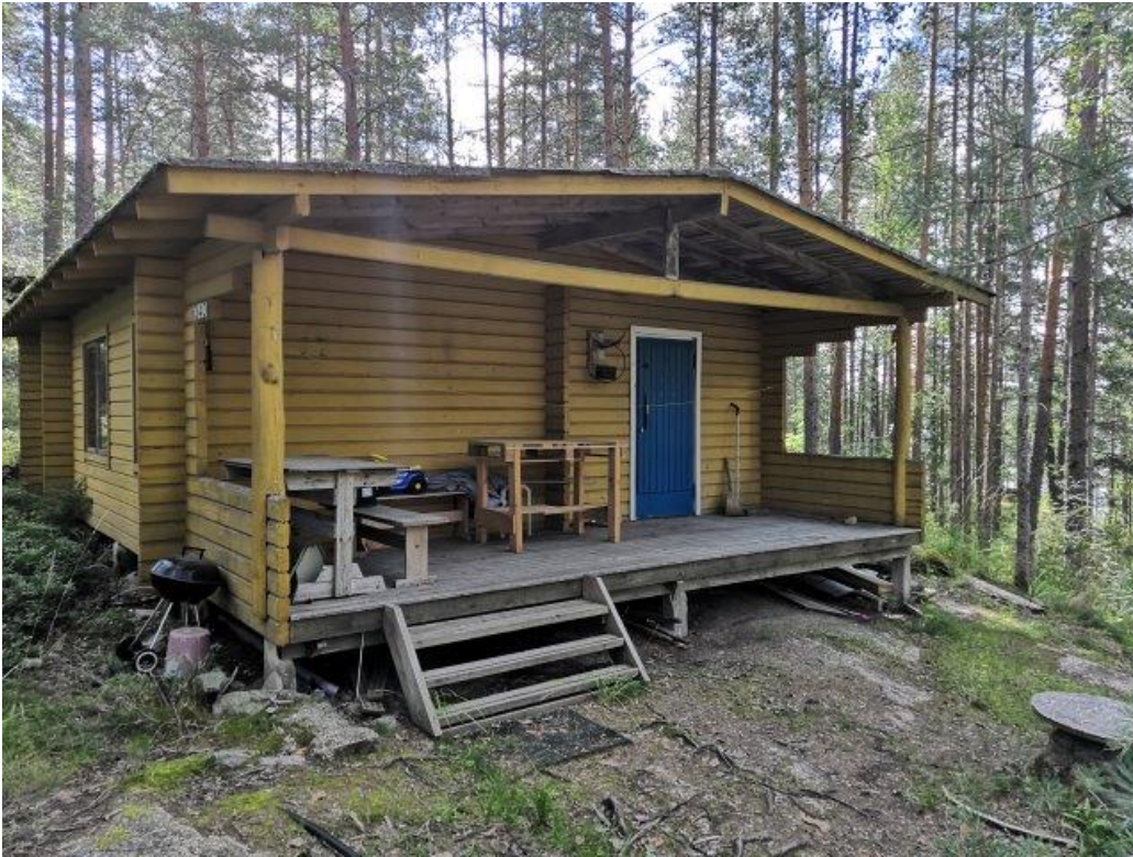
Tyypillinen esimerkki alueen rakennuskannasta 1970-luvulta, suuri osa takamaaston rakennuskannasta (entisistä vuokramökeistä) on purkukuntoista
