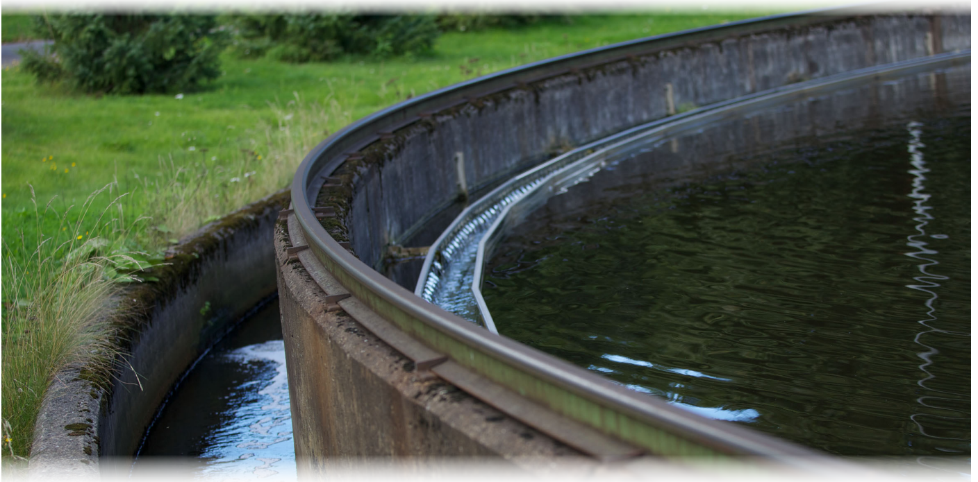
Kuva Toikansuon jätevedenpuhdistamo, Lappeenrannan Energia Oy.
